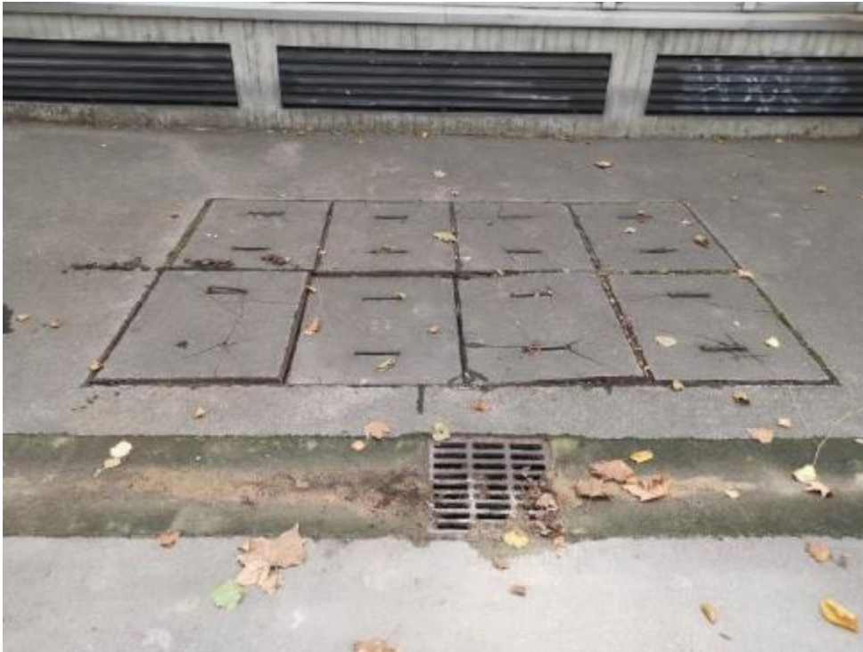
Vue d'ensemble de la tête de forage sur le trottoir - Rue du Général Dayan, fermée par des trappes en béton non étanches, amovibles
